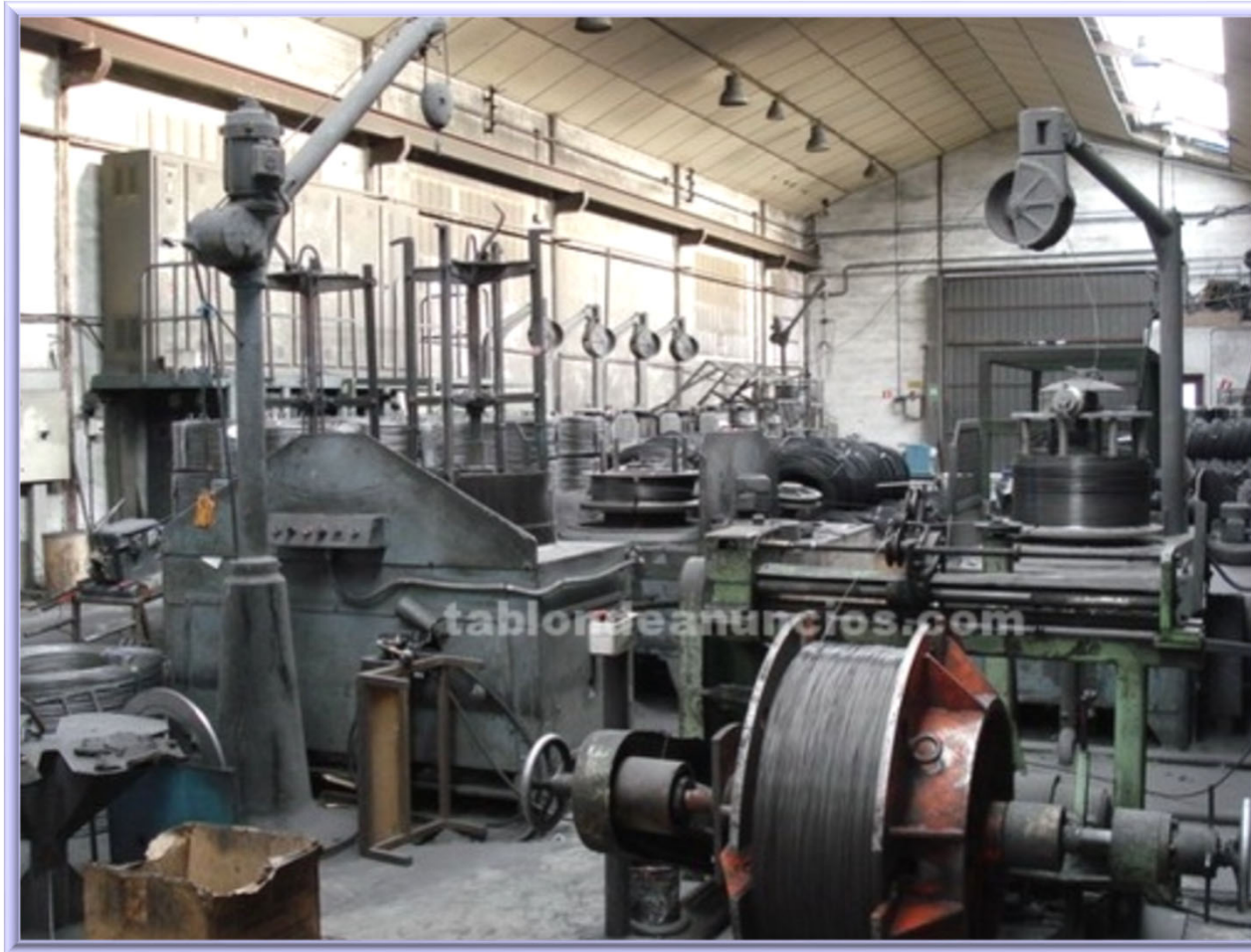
Motores asíncronos en máquinas trefiladoras
